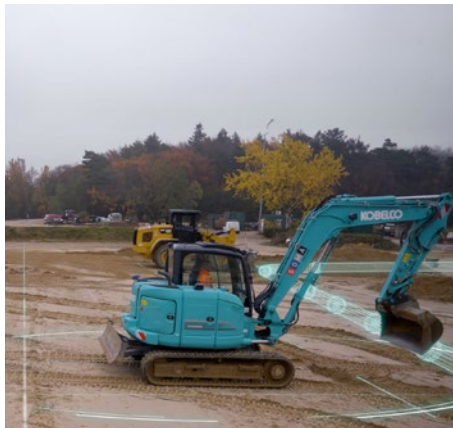
Als de graafmachine te dicht bij de hogedrukpijpleiding komt, gaat er een alarm af in de cabine.
